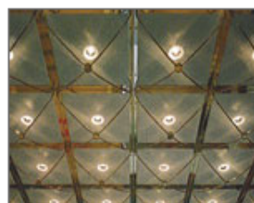
豊明・藤田学園合同校舎 天井照明飾り金物
